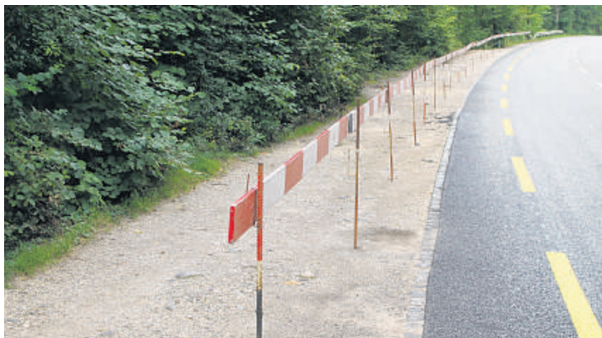
Vorbei mit Parkieren: Der Randstreifen entlang der Boningerstrasse wurde aus Sicherheitsgründen «verbarrikadiert». Es ist vorgesehen einen Schutzwall aufzuschütten.
